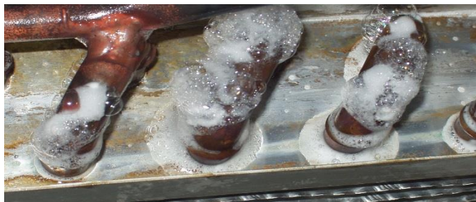
Figure 1 : Fuites d'un réseau de froid. Source : http://www.frigoristes.fr
